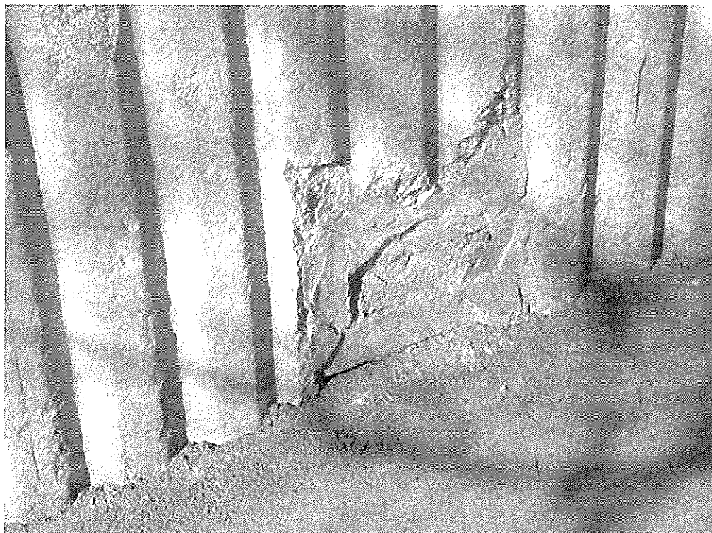
Рис. 3.2.7. Фрагмент стены по оси «Ж» в осях «7» - «6». Обрушение штукатурного покрытия цоколя.
