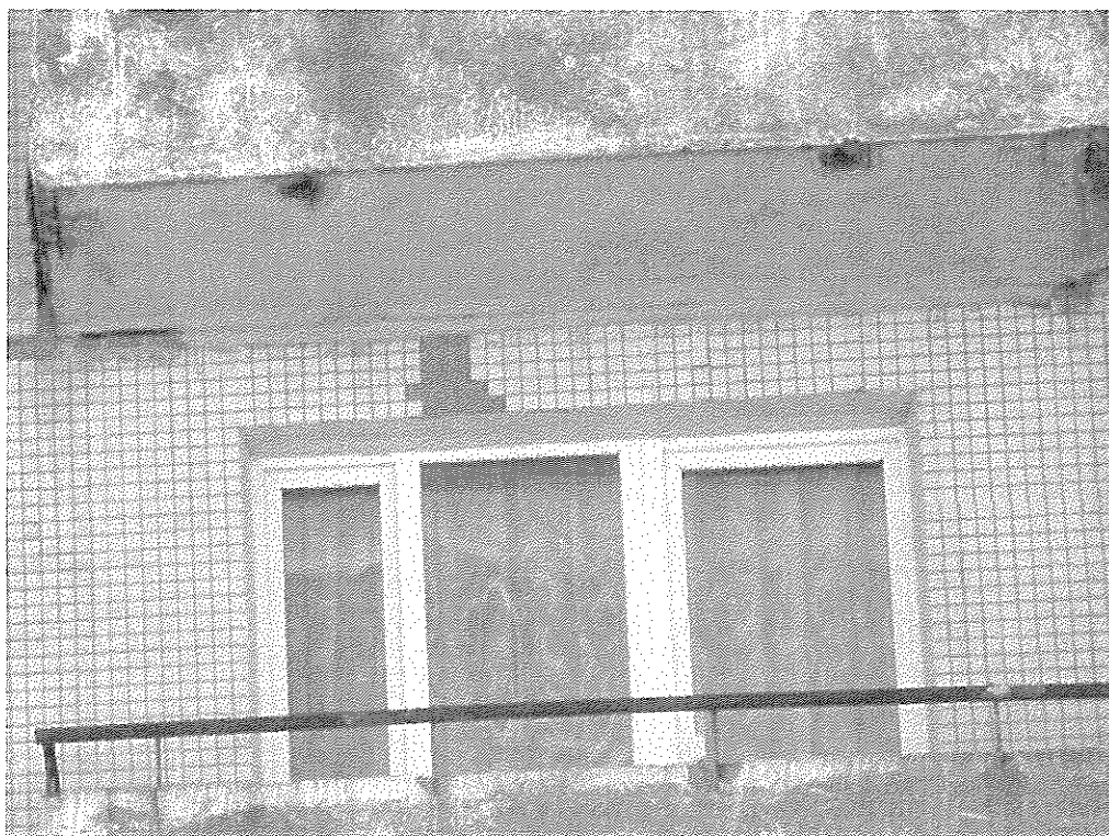
Рис. 3.2.6. Фрагмент стены по оси «А» в осях «6» - «7». Локальное обрушение облицовочной керамической плитки в уровне 6-го этажа.
