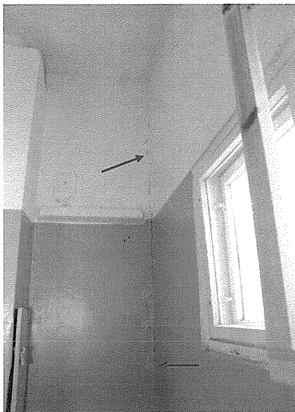
Рис. 3.2.22. Помещение лестничной клетки в осях «4» - «6» / «Е» - «Г». Трещина в месте стыкования продольной и поперечной стен в уровне междуэтажной площадки 8-го – 9-го этажей.
