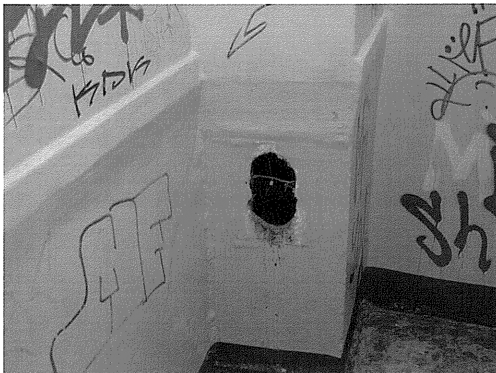
Рис. 3.2.21. Помещение лестничной клетки в осях «4» - «6» / «Е» - «Г». Пробитое отверстие в стволе мусоропровода в уровне междуэтажной площадки 2-го – 3-го этажей.
