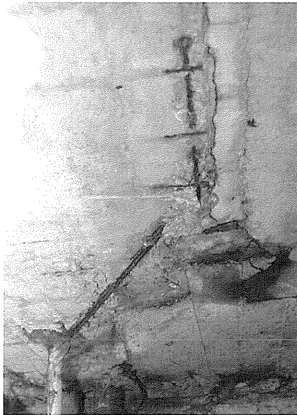
Рис. 3.2.12. Помещение подвала в осях «6» - «7» / «Ж» - «Г». Оголение и коррозия арматуры плиты перекрытия.
