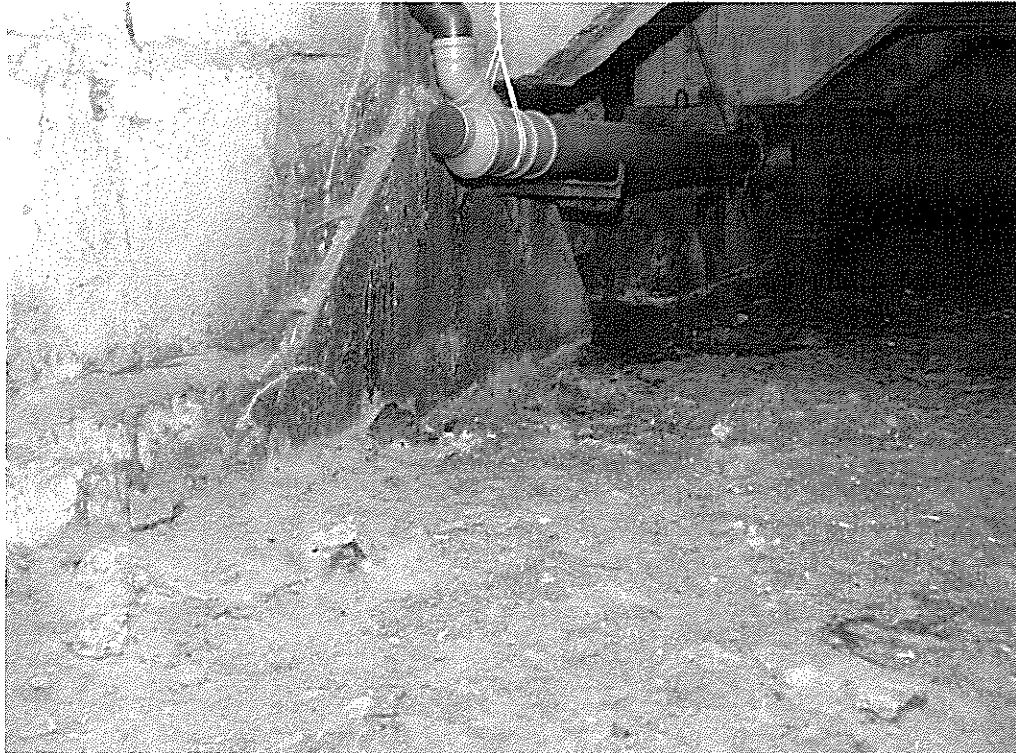
Рис. 3.2.15. Помещение подвала в осях «1» - «8» / «А» - «Г». Намокание стены вследствие протечек инженерных коммуникаций.
