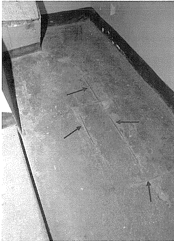
Рис. 3.2.25. Помещение лестничной клетки в осях «4» - «6» / «Е» - «Г». Оголение арматуры междуэтажной площадки в уровне 1-го – 2-го этажей.
