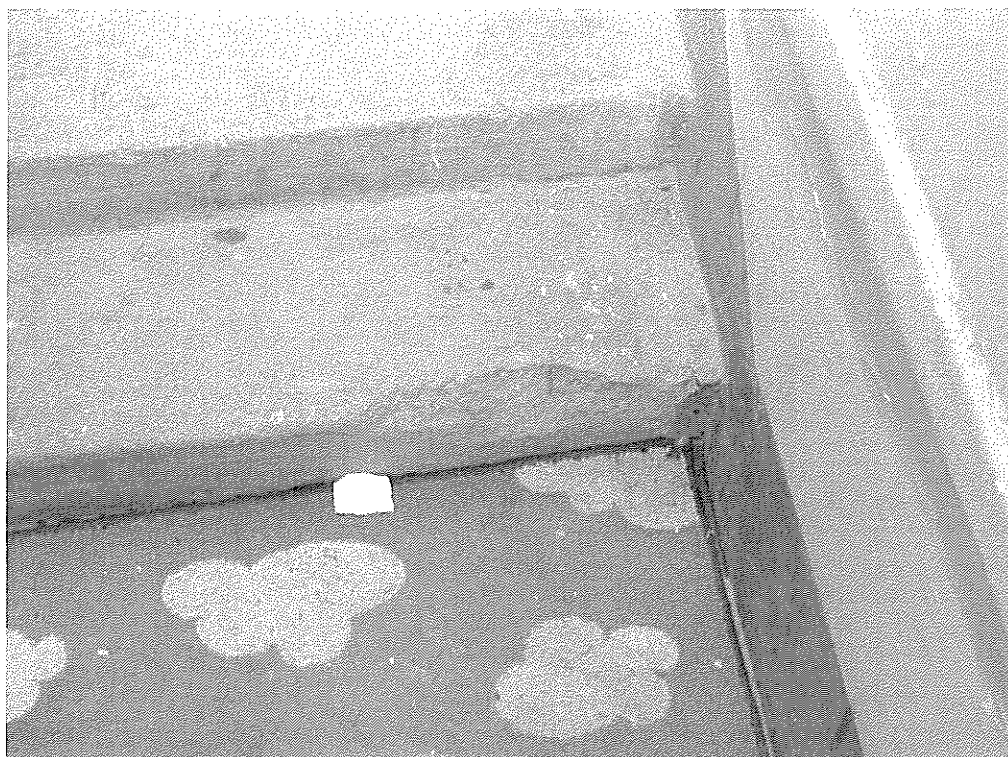
Рис. 4.2.24. Помещение лестничной клетки в осях «3» - «5» / «Е» - «Г». Скол бетонной ступени в уровне 1-го этажа.
