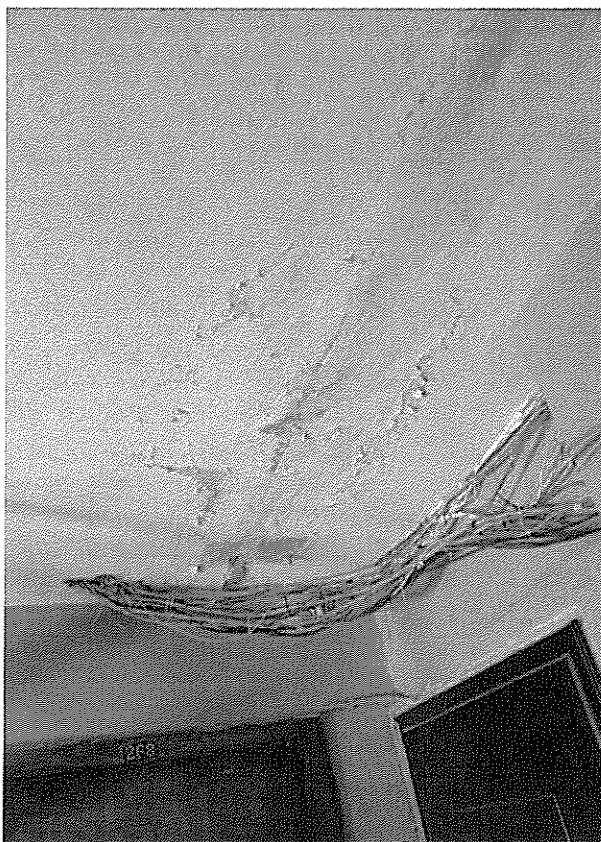
Рис. 4.2.20. Помещение лестничной клетки в осях «3» - «5» / «Е» - «Г». Следы протечек на плите перекрытия в уровне 9-го этажа.
