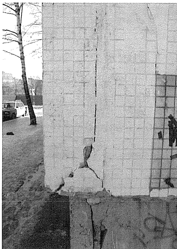
Рис. 4.2.9. Фрагмент стены по оси «А» у оси «1». Трещины по стыку стеновых панелей в уровне 1-го этажа и цоколя.
