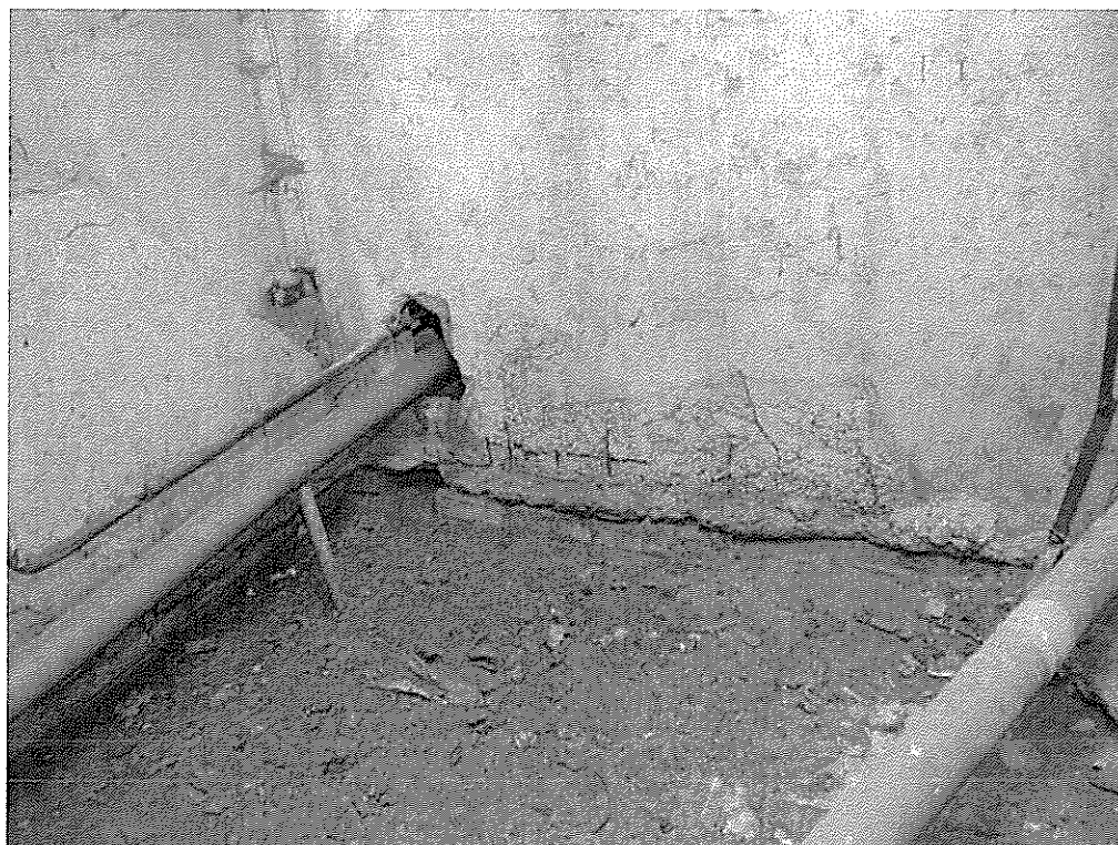
Рис. 4.2.15. Помещение подвала в осях «1» - «3» / «А» - «Д». Оголение и коррозия арматуры в нижней части стеновой панели.
