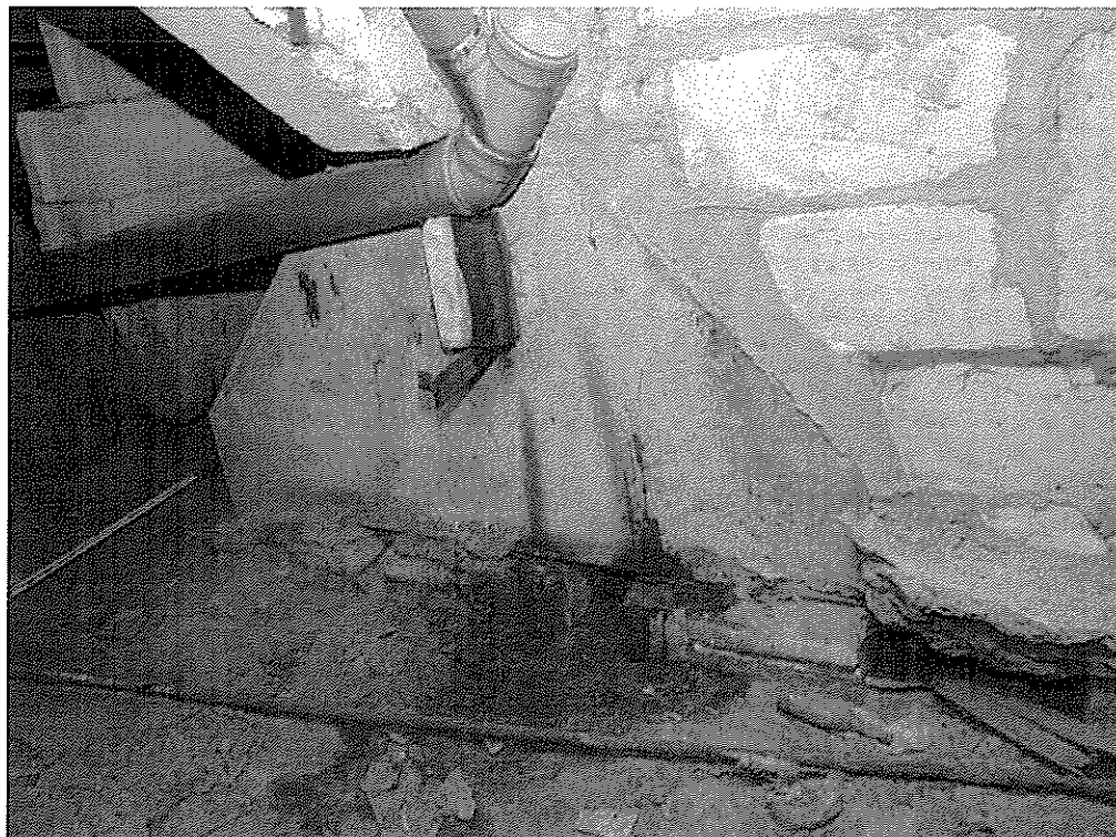
Рис. 4.2.18. Помещение подвала в осях «1» - «8» / «А» - «Г». Намокание стены вследствие протечек инженерных коммуникаций.
