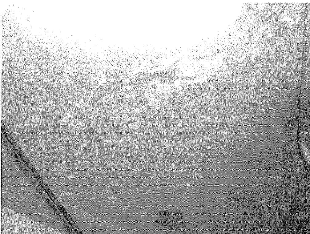
Рис. 4.2.19. Помещение подвала в осях «5» - «8» / «Г» - «Е». Высолы по плите перекрытия.
