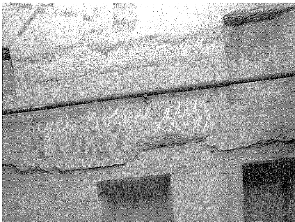
Рис. 4.2.13. Помещение подвала в осях «1» - «2» / «А» - «Д». Сеть трещин по стене.
