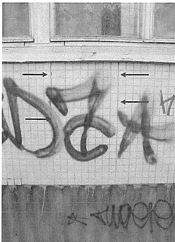
Рис. 4.2.5. Фрагмент стены по оси «А» в осях «1» - «2». Трещины по швам облицовочной керамической плитки в уровне 1-го этажа.
